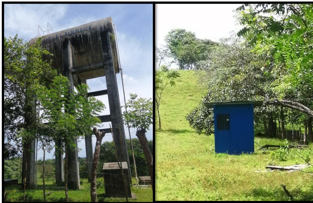
Tanque de reserva y turbina del acueducto de Tebario
